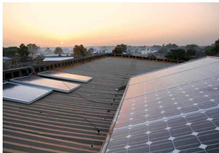
Les panneaux solaires qui alimentent la pompe à eau sont posés sur le toit du centre de santé.
